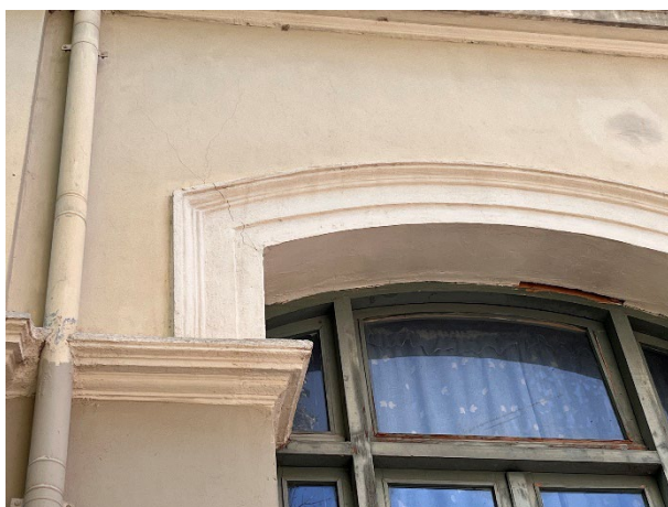
Εικ. 3.13 :Ρωγμή σε υπέρθυρο
